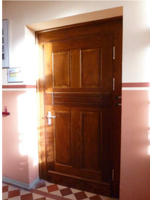
Neue Brand- und Schallschutztüren (2014)
