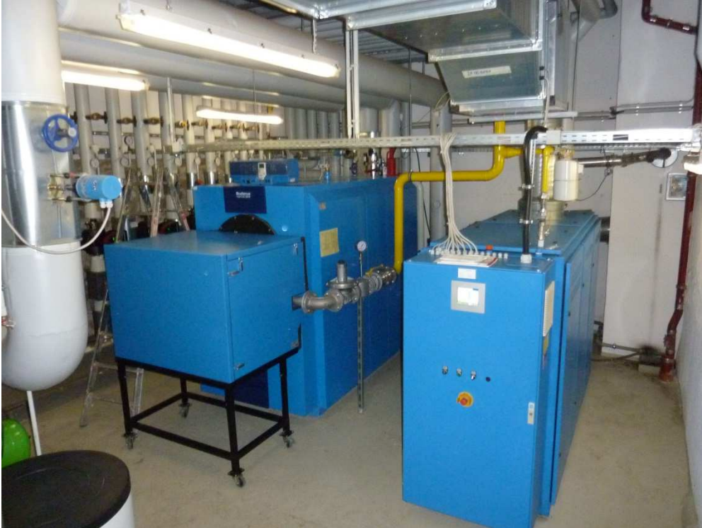
Neues Blockheizkraftwerk nach Energetischer Sanierung (2014)
